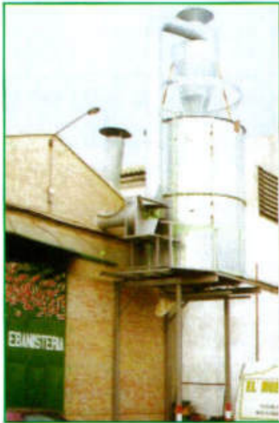
Depósito de extracción central.
